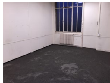
Coulage de la dalle de béton pour mise à niveau du sol
